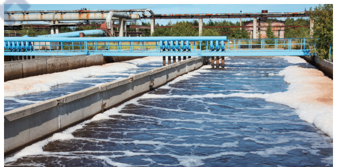
Hệ thống xử lý nước
